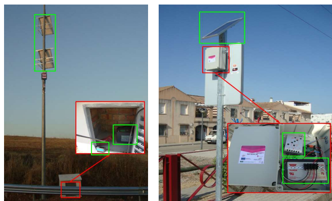
Figura 6. Sistemas de alimentación autónomos para el Punto Concentrador y para Puntos de Señalización.
