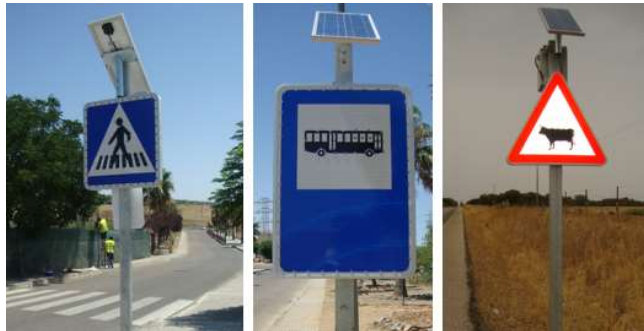
Figura 5. Señalización LED instalada.
